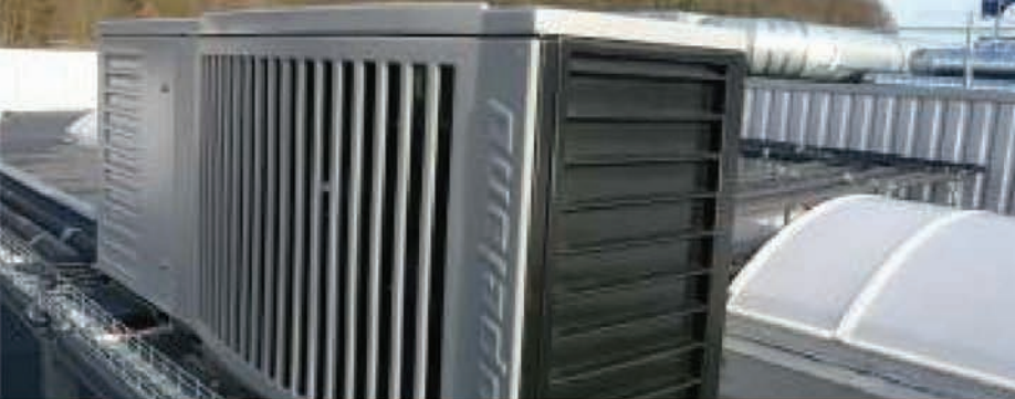
Le groupe Copeland OMTQ 90D alimente 21 postes « froids »
